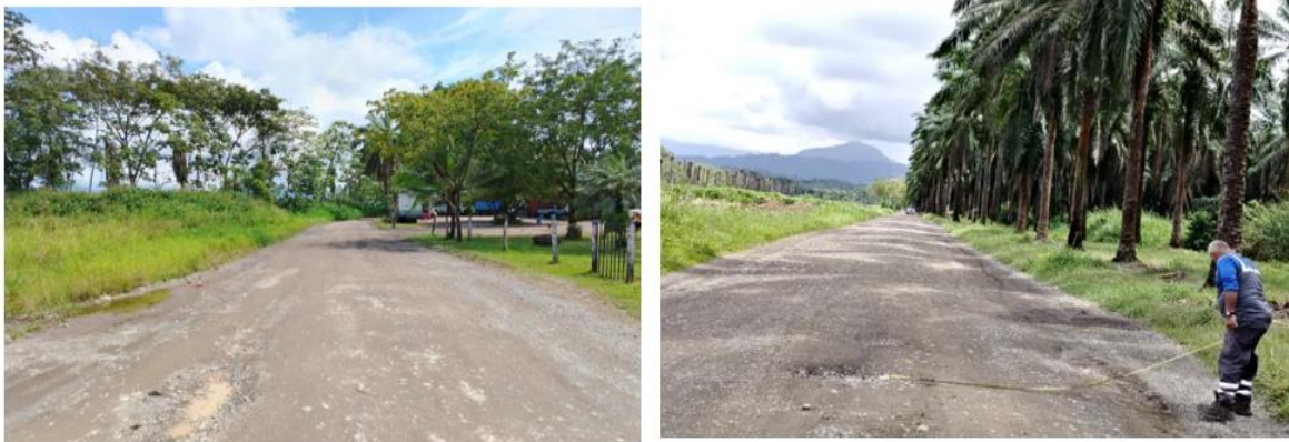
Ilustración. 1 y 2. Presencia de baches a lo largo de la longitud de la vía.
