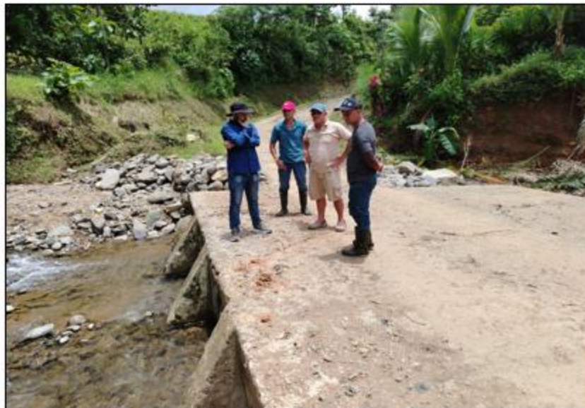
Ilustración 2. La estructura de paso actualmente se encuentra en regular estado.
