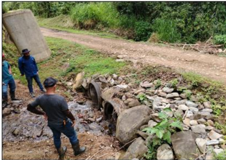
Ilustración 3. Paso de alcantarillas cuenta con 2 líneas de tubería.
