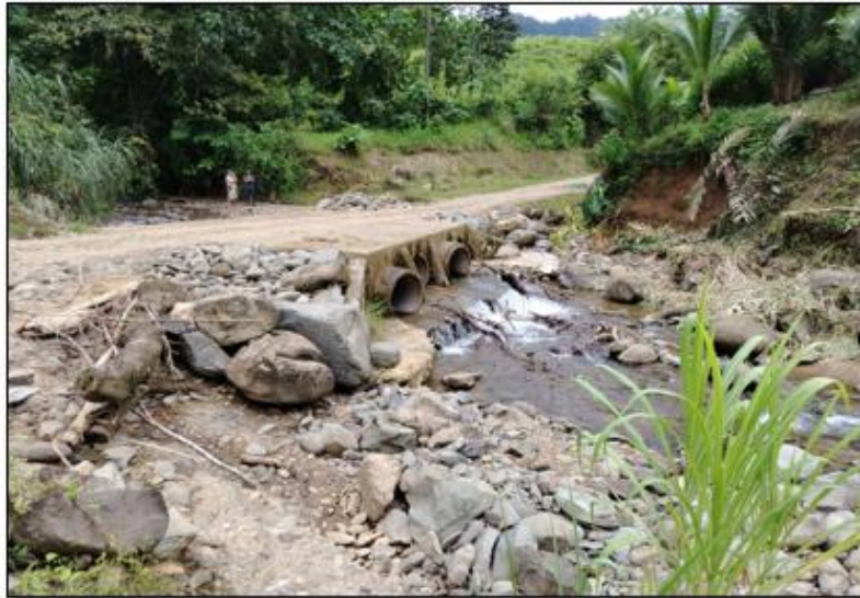
Ilustración 1. Vado en concreto, cuenta 4 líneas de alcantarillas, altamente sedimentado.
