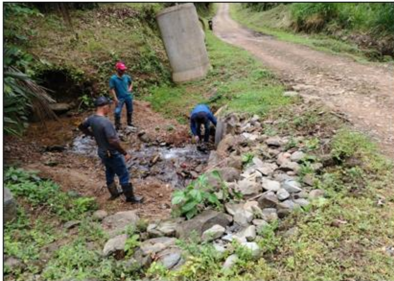
Ilustración 4. Actualmente no cuenta con la capacidad de trasportar la escorrentía pluvial.
