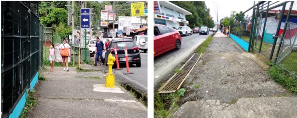
Ilustración 1 y 2. Aceras en mal estado, no aptas para la circulación de estudiantes, personas con movilidad reducida y peatones.
