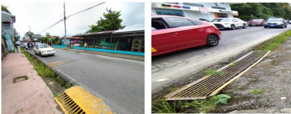
Ilustración 3 y 4. Se observa un solo reductor de velocidad y parrilla en mal estado.
