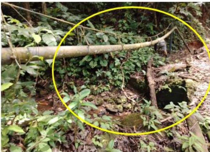
Imagen 3. Primer Paso de alcantarillas en mal estado, tubería de agua potable expuesta. ----
