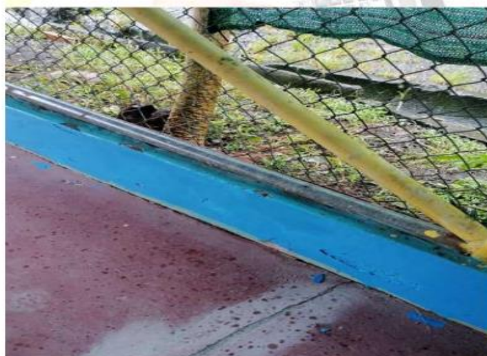
Imagen 5: malla en mal estado y muro muy bajo.
