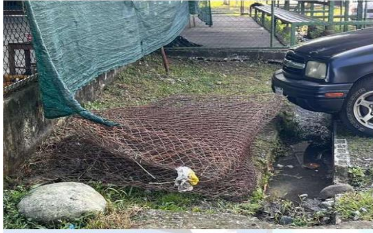
Imagen 6: malla en mal estado y muro del costado.
